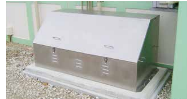
管理用ボックスを開け発電機を接続
