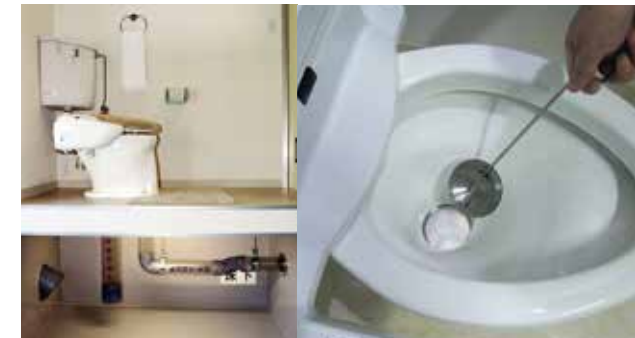
汲み取り式へチェンジする「ハイブリッド便器」と「地下ピット」
